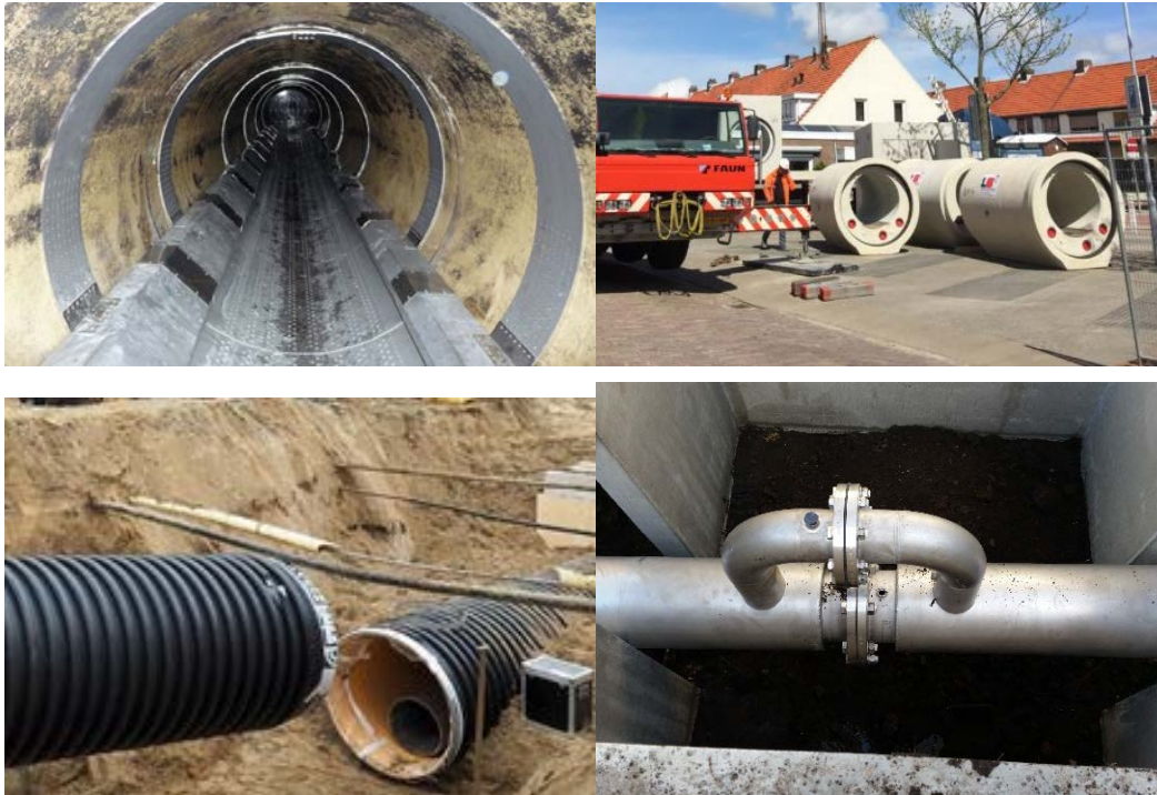
Figuur 2.3: Van links naar rechts en boven naar onder: (1) Vrijvervalrioolwisselaar intern, (2) Vrijvervalrioolwisselaar intern prefab, (3) Vrijvervalrioolwisselaar extern prefab, (4) Persleidingrioolwisselaar extern prefab.
