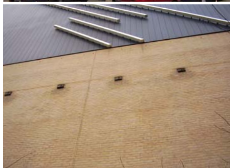
Gierzwaluwkasten in de muur van de goudse schouwburg.
